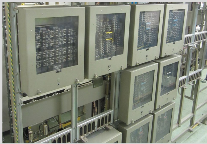
Blick in den Relaisraum mit Weichen- und Signalsätzen Typ DOMINO 55.
