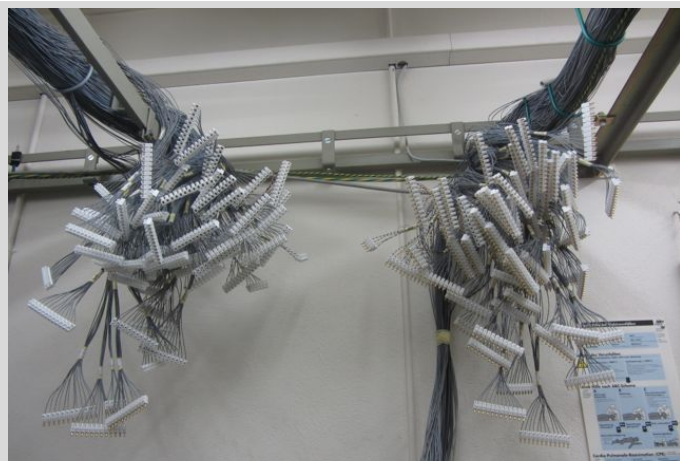
Abb. 9: Einer der Aderstränge im Relaisraum, welcher bereits vollständig mit steckbaren Verbindungen ausgerüstet worden ist.
