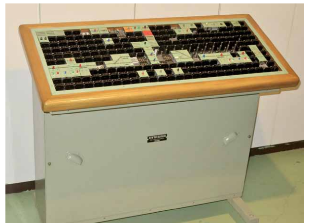
Neu aufgebauter und renovierter Stelltisch Doppleschwand-Romoos (ex. Därstetten).
