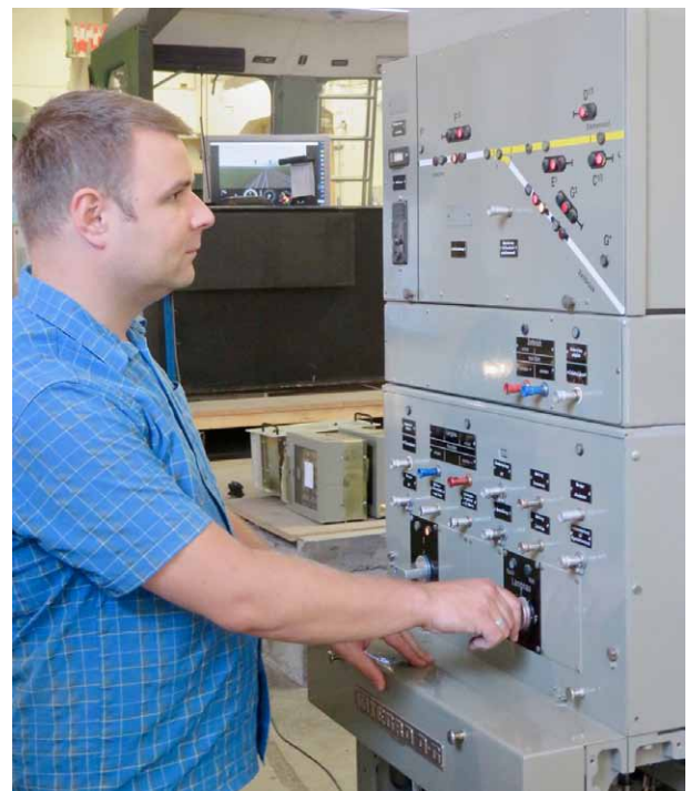
Das Stellwerk Obermatt steht über die neu entwickelte Middleware mit dem Fahrsimulator ZUSI in der Re 4/4 (Hintegrund) in Verbindung. Die Inwertsetzung der Middleware bis zur Anwendungsreife stellt eine grosse Herausforderung dar.
