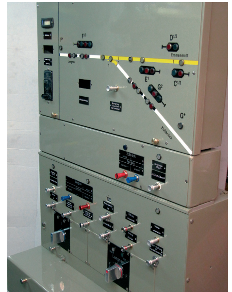
Das rekonstruierte Integra-Vertikalschalterwerk.
