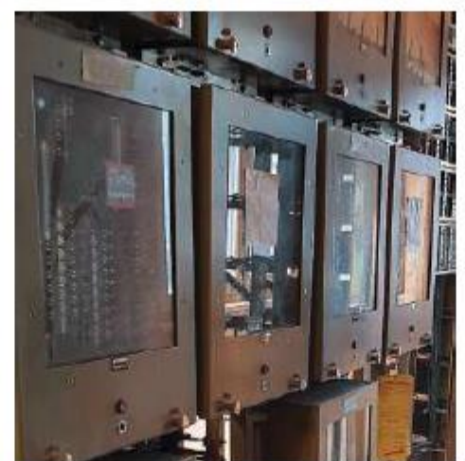
Blick hinter die Kulissen eines Stellwerks – dieses Relaisstellwerk befindet sich noch im Aufbau.
