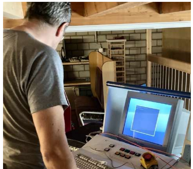
Der FASI wurde zum ersten Mal seit langer Zeit wieder eingeschaltet.
