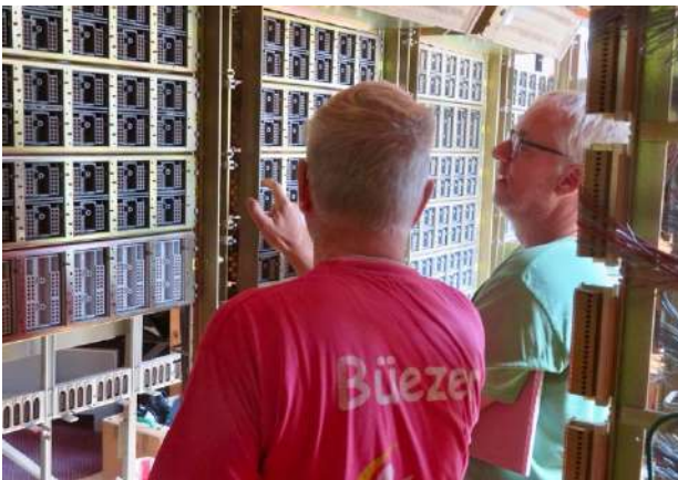
Hans Bhend und Roger Heine im Relaisraum des Stellwerks von Doppleschwand.
